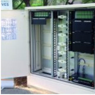
Armoire fibre optique
